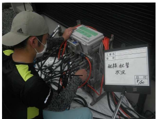
(配線、配管接続状況)
