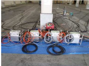
分岐バルブ設置 (配線・配管状況)
